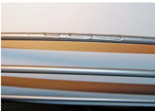
farba źle zwilża powierzchnię w wyniku niewłaściwego przygotowania
